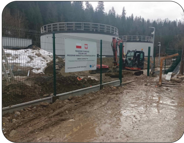
Stacja Uzdatniania Wody w Mizernej
